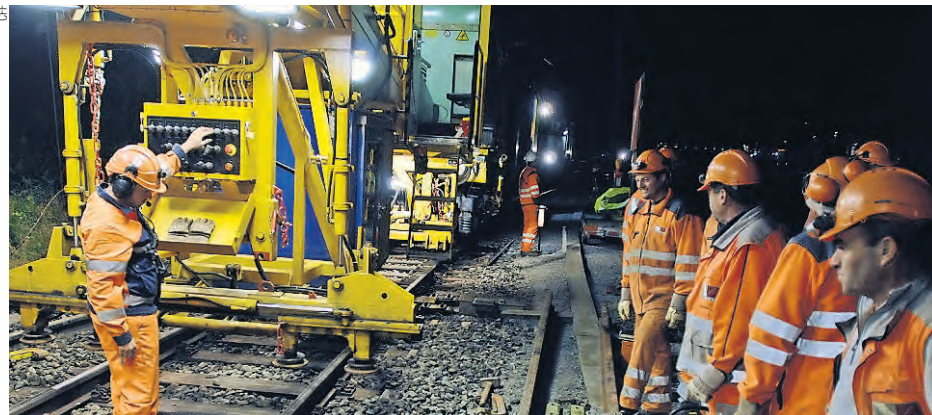
Dépassements d'heures, travail de nuit interminable: de multiples infractions à la loi sur le travail ont lieu sur les chantiers des CFF. L'entreprise est au courant depuis des mois mais n'a pas bougé.
