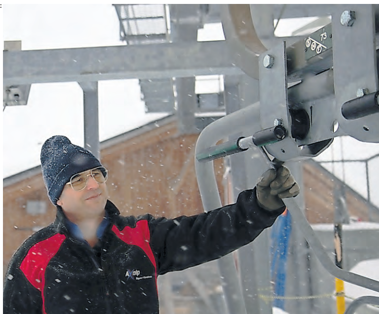
Certains travaux ne sont réalisables que sur une installation à l'arrêt.
