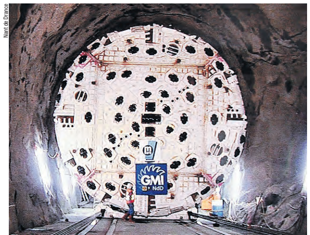
Die Tunnelbohrmaschine, die zurzeit in Nant de Drance im Einsatz steht, ist zuvor schon für den Bau des Lötschberg-Basistunnels verwendet worden.
