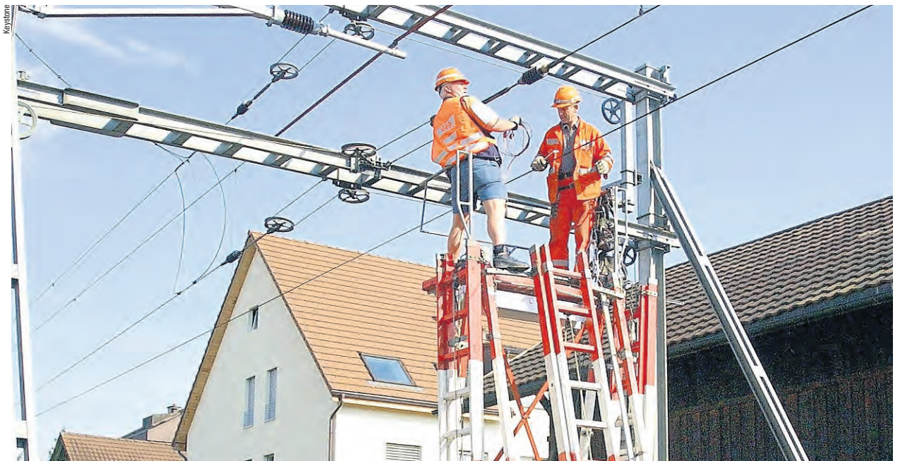
Immer, wenn etwas passiert, braucht es zusätzliche Leute – zum Beispiel, wenn ein Auto auf einem Übergang die Fahrleitung heruntergerissen hat.
