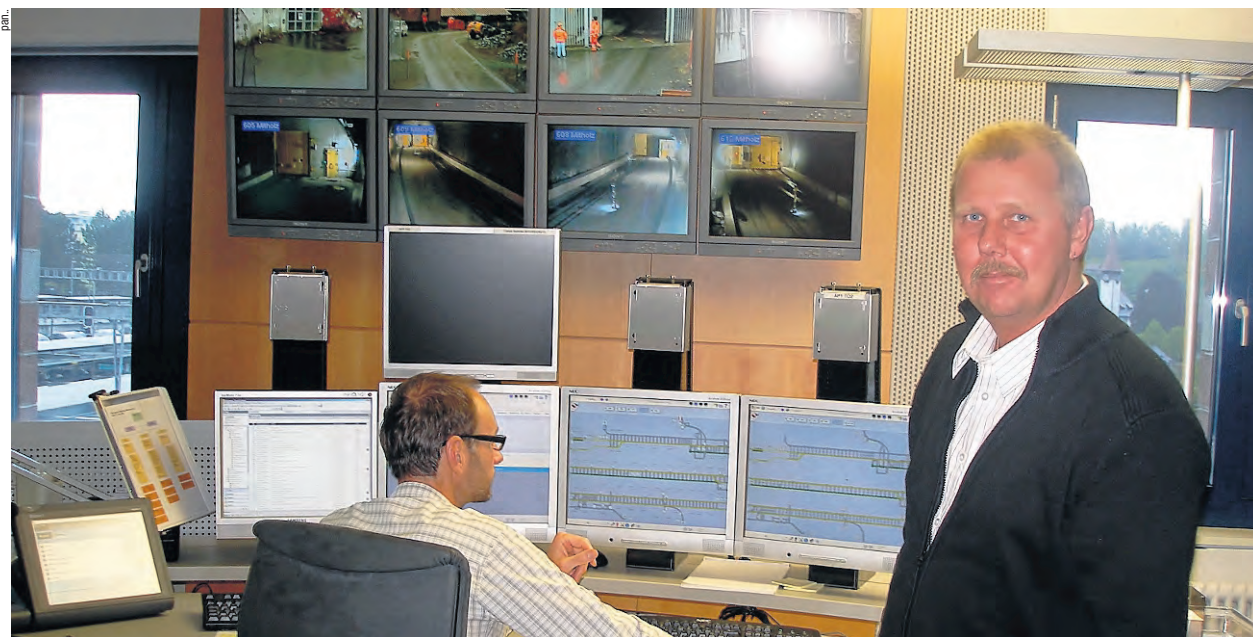
Franz Schmid vor einem Pult der Tunneloperateure. Via Fernseh- und Computermonitor ist die Lage im und um den Tunnel kontrollierbar.
