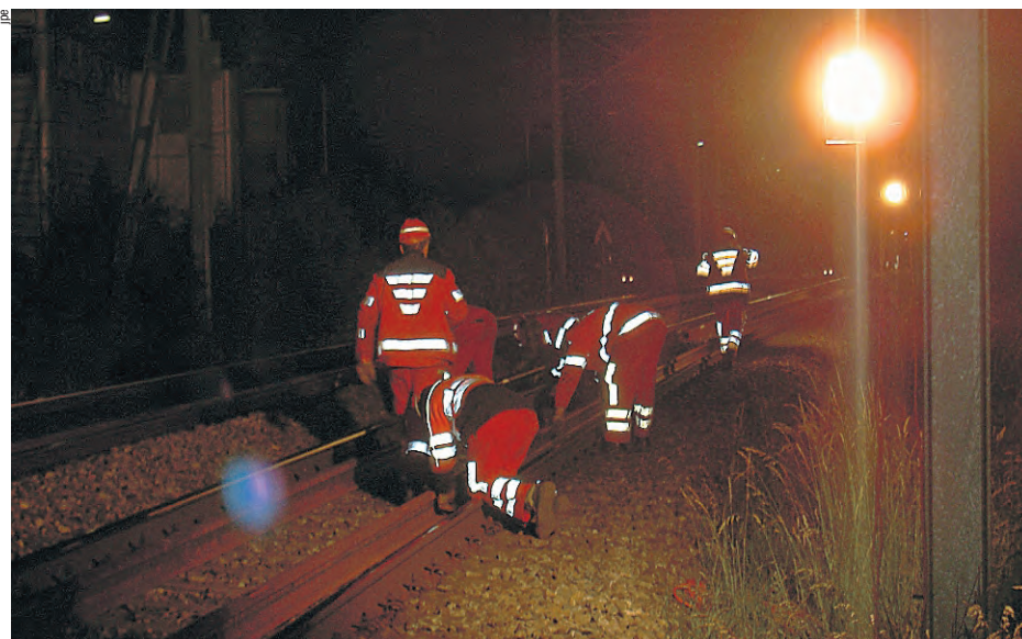
Le travail sur les voies se fait dans des conditions souvent pénibles: froid, vent, neige, pluie et également de nuit.
