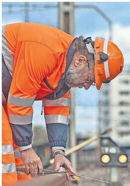
Hans Ulrich Keller, Lavori «Riparo per la vostra sicurezza».
